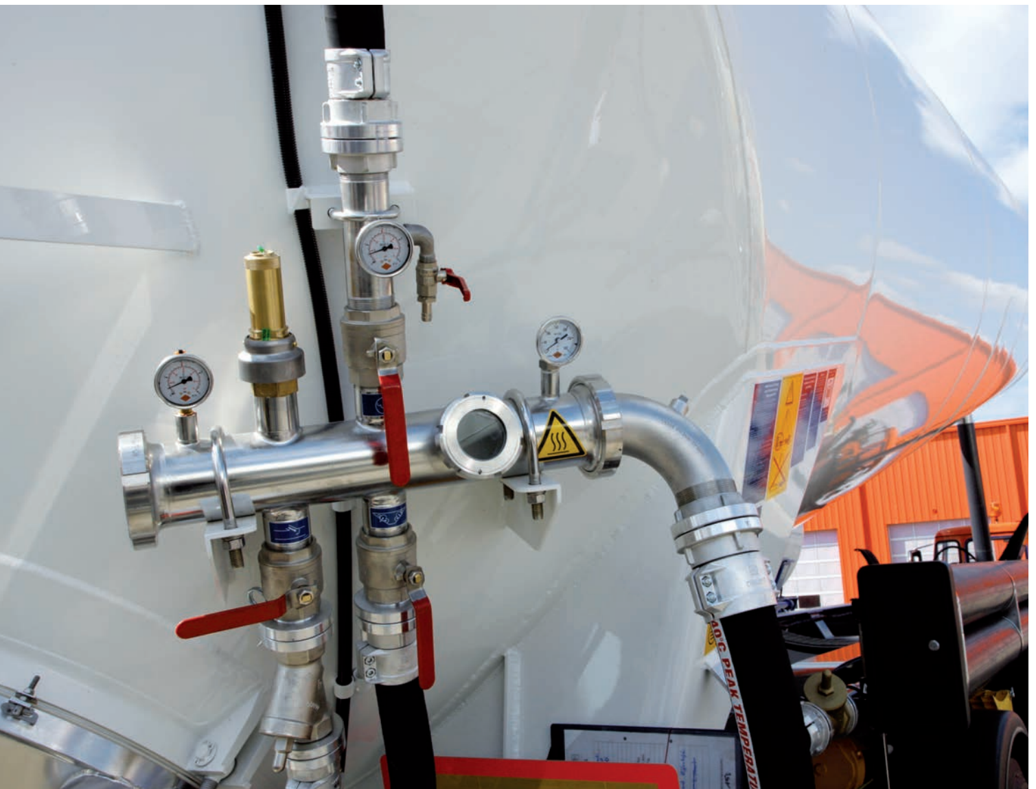
Frei abblasendes Sicherheitsventil im Einsatz auf einem Silofahrzeug
