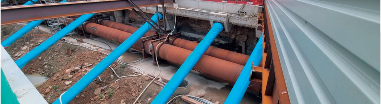
Detailansicht Bypassleitung Hauptabwasser-Sammelkanal Pilgramgasse
