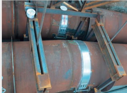
Zwei parallel geführte Rohrleitungen verbunden mit Straub Rohrkupplungen
