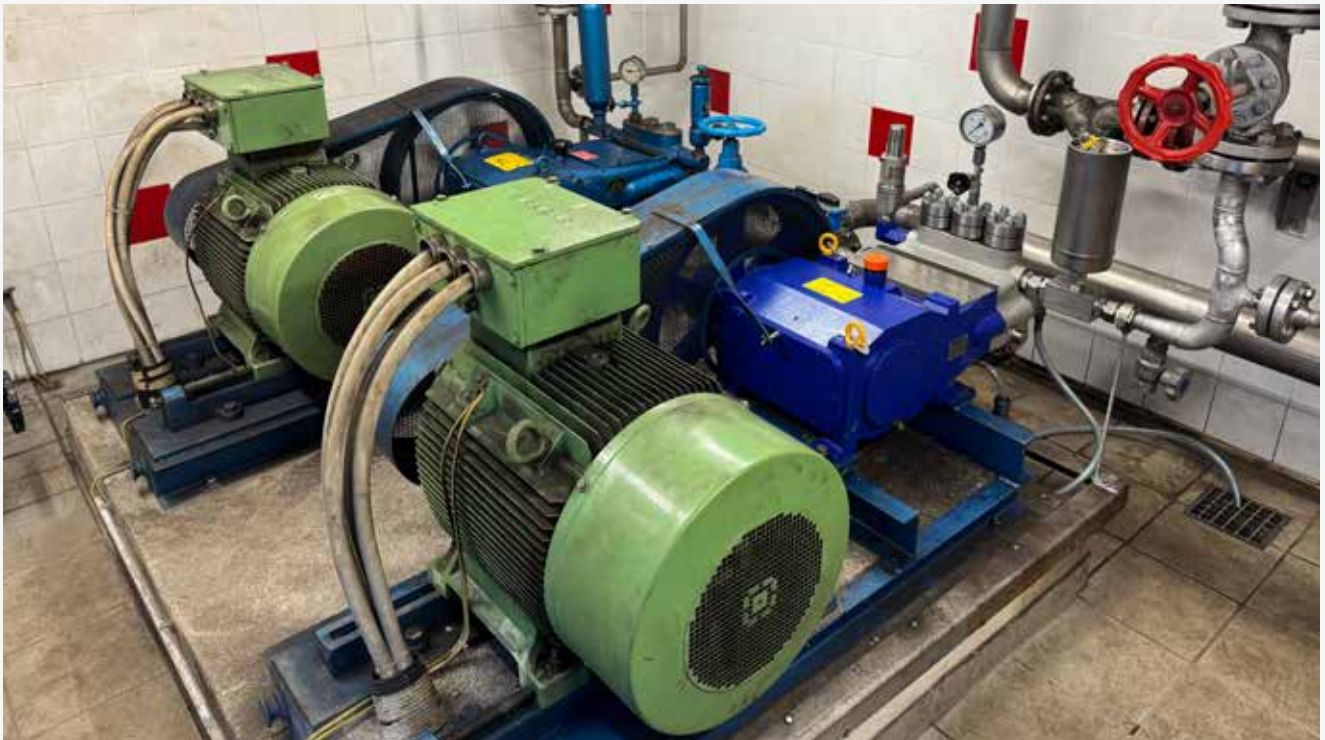
Abb. 1: Die neu verbaute Pumpe (vorne) stellt die Trinkwasserversorgung auf den Hutterer Böden sicher. (Foto: Gemeinde Hinterstoder)
